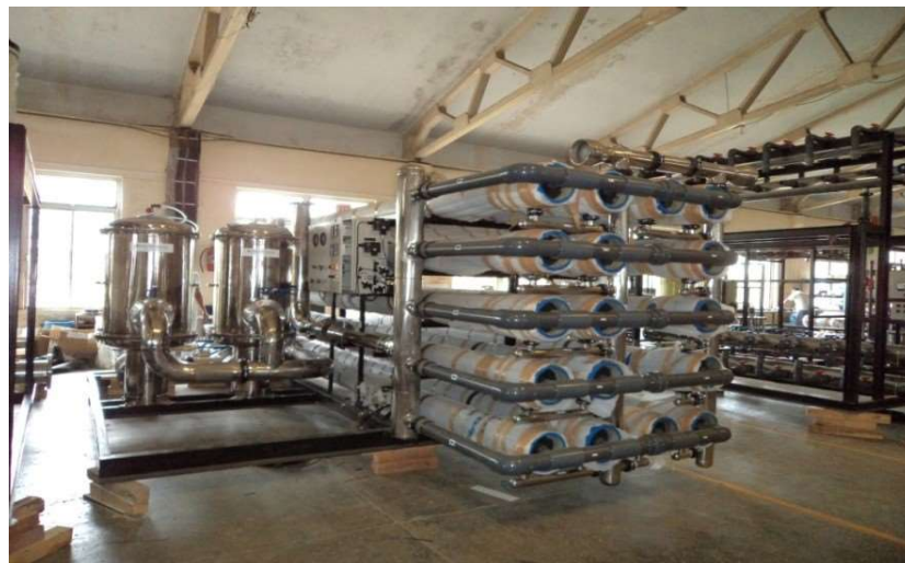
RO Skid 100 M 3
